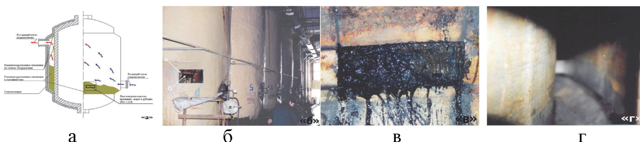
Рис. 10. Очистка резервуаров ОАО «МКШВ»: а – схема течения хладоносителя в рубашке резервуаров ОАО «МКШВ»; б – общий вид резервуара с вырезанным в рубашке смотровым люком; в – фото смотрового люка до промывки, свидетельствующее об отсутствии циркуляции хладоносителя в нижней части рубашки резервуара; г – фото смотрового люка резервуара после промывки
