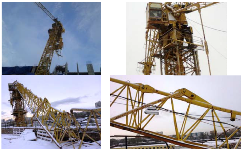
Рисунок 1 - Разрушение башенного крана КБ-473
