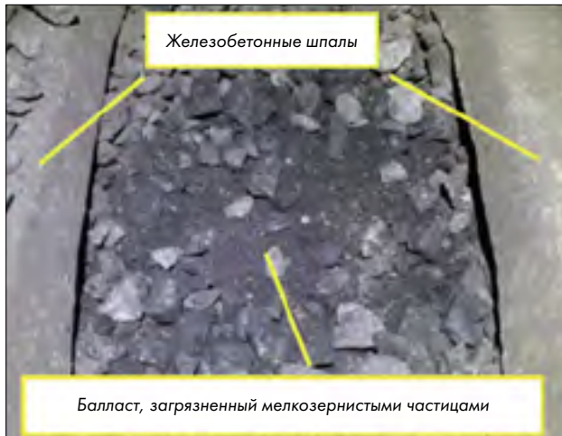
Рис. 1. Состояние загрязненного путевого балласта в тоннеле
